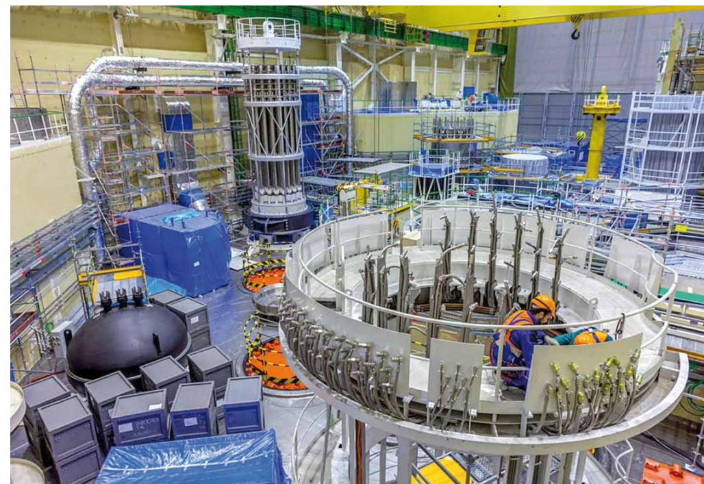
Reaktorová sála tretieho bloku atómovej elektrárne Mochovce.
